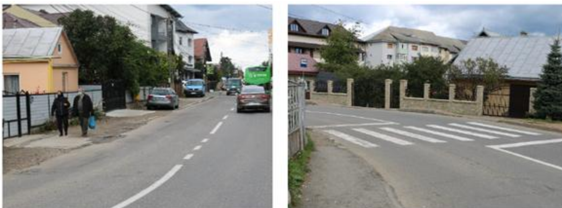
Figura 2.5.54 Trotuare în stare necorespunzătoare (exemplificare)
