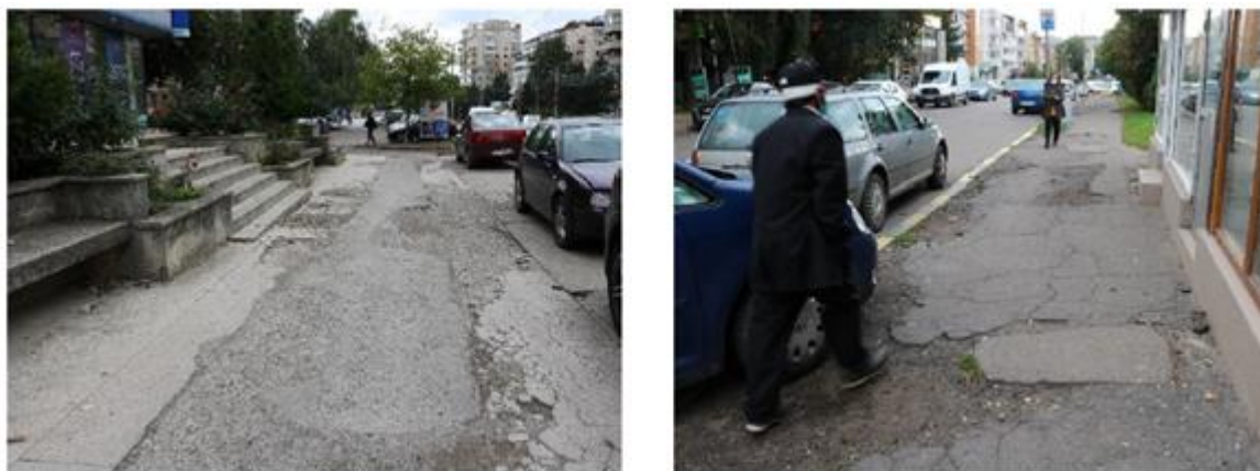
Figura 2.5.51 Trotuare în stare necorespunzătoare (exemplificare)
